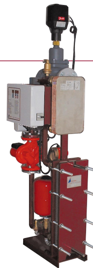
Exemple d'application : rubis vapeur (système de production d'eau chaude sanitaire)
