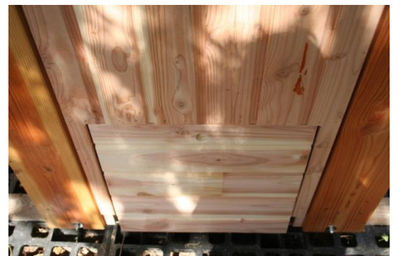
TRAPPE DE RECUPERATION A L'ARRIERE DE LA CABINE
