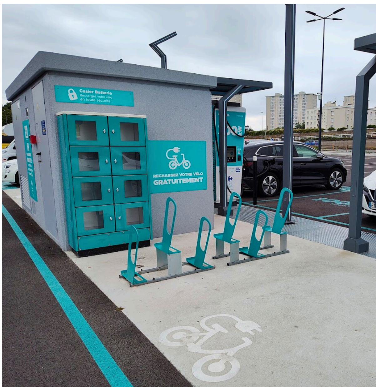
Photo 1 : hub mobilité avec armoire de recharge
