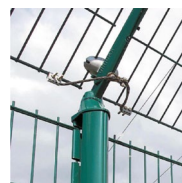
Mise à la terre
