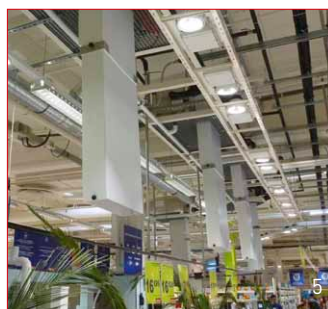
Goulottes de sortie de glace directement sur l'étal poissons
