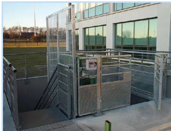
Porte et portillon avec serrures électriques
