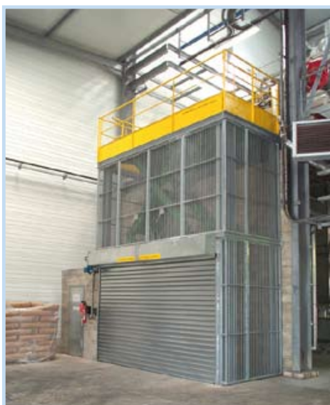
Rideau métallique en partie basse avec commande par boîte à boutons
