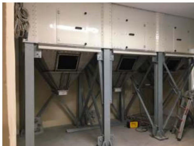
Batterie à cellules à parois plates, de type sandwich lisse, pour le stockage conditionné du blé, sur structure métallique.
