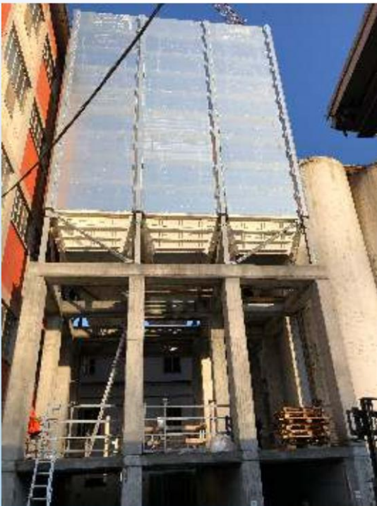
Batterie à cellules à parois plates, de type sandwich lisse, sur structure en béton armé.
