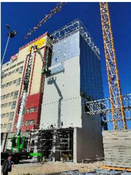
Batterie à cellules à parois plates, type sandwich lisse, sur structure métallique pour chargement de camions de semoule en vrac.
