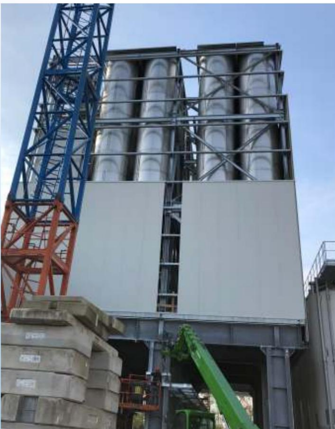
Silos boulonnés en acier inoxydable, disposés en batterie, sur une structure métallique.
