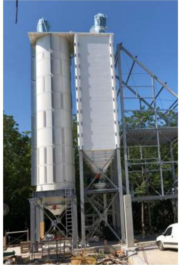
Cellules à paroi simple plane, de type sandwich lisse, sur structure métallique, disposées avec un silo rond pour le stockage de la farine.
