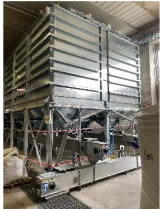
Batterie à cellules à parois plates, lisses avec raidisseurs extérieurs apparents, sur une structure métallique dans un entrepôt en béton.
