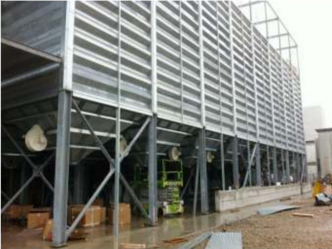
Batterie à cellules à parois plates, de type ondulé, sur structure métallique.
