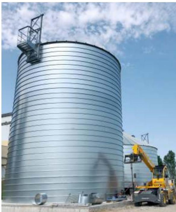
Silos spiralés lisses à fond plat.
