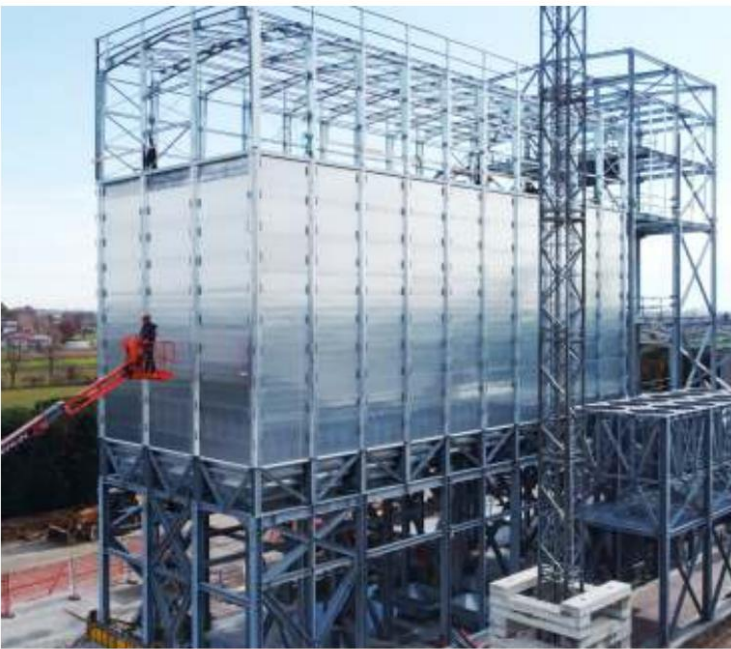
Batterie à parois plates, type sandwich lisse, avec construction industrielle en métal.
