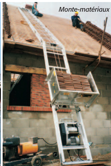
Installé sur un support pour translation
