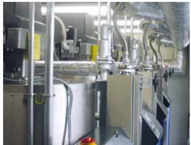
Fig. : Installation de vapeur en conteneur
