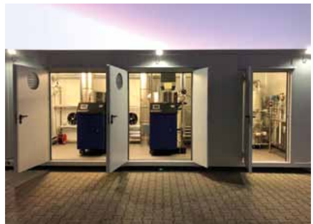
Fig. : Installation de vapeur en conteneur
