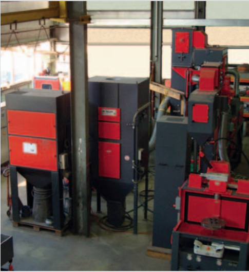
Le centre d'essais avec divers équipements
