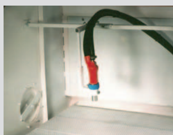
Cabine ST avec treillis
