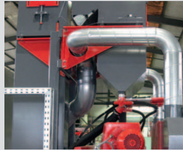
Épuration de la grenaille via séparateur en cascade
