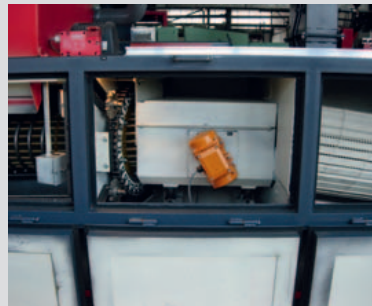
Passage du tunnel d'ébavurage au tambour de nettoyage avec tamis vibrant
